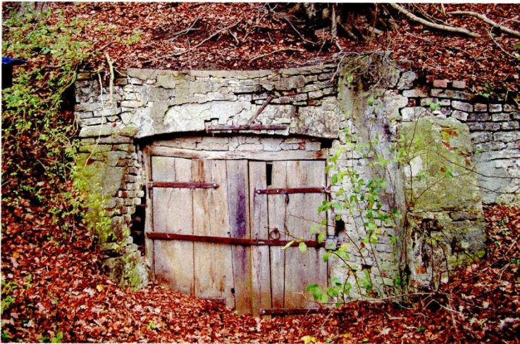
Abb. 7: Eingang zum Keller Altenmünster. Vor allem Wurzelwerk führt zur Verschiebung der Ziegel im Kellergewölbe und leitet damit den Verfall ein.
